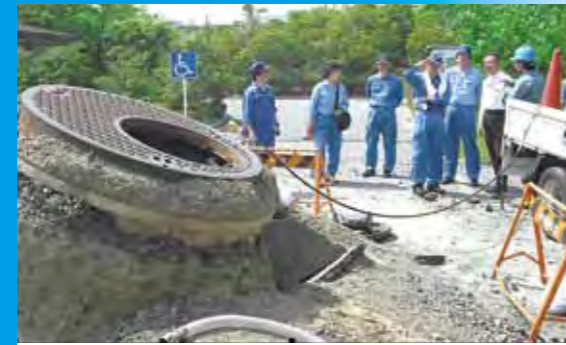
地下に埋設した非常用貯水タンクのマンホールが液状化により破損した千葉県浦安市の公園。
